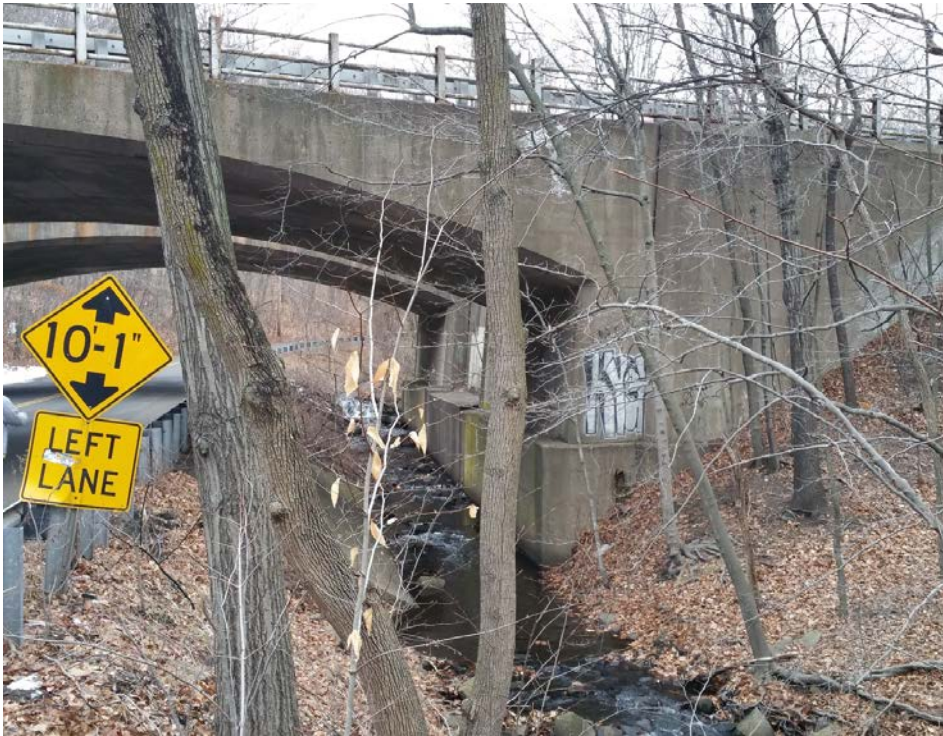
Vista de los puentes de la Ruta 15 sobre Wintergreen Avenue y Wintergreen Brook
